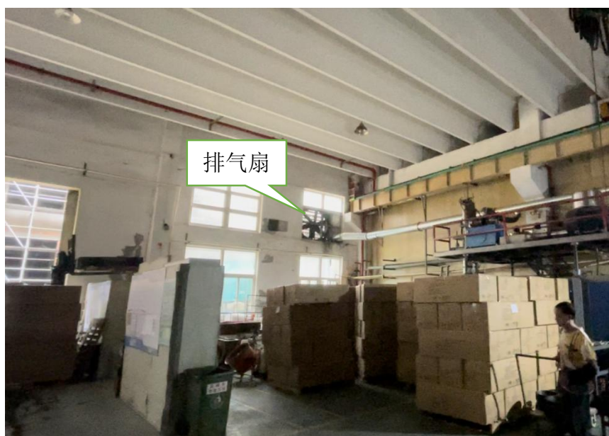
图 3.5 车间机械通风设备照片
